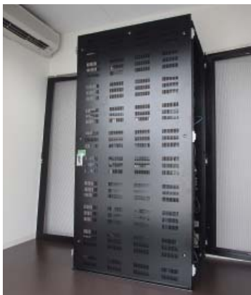
サーバの仮想化技術により、これ1台で院内の医療システムを一元管理している。
